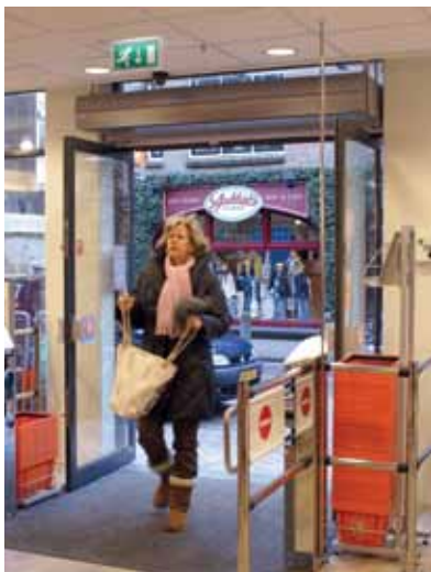
Zamontowanie kurtyny DF 2 nad drzwiami pozwala ograniczyć przeciągi.
